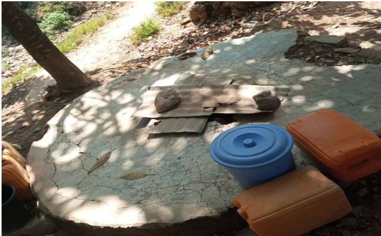
Figure 4 : Puits sans protection
